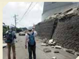
熊本地震 益城町の被災状況調査
